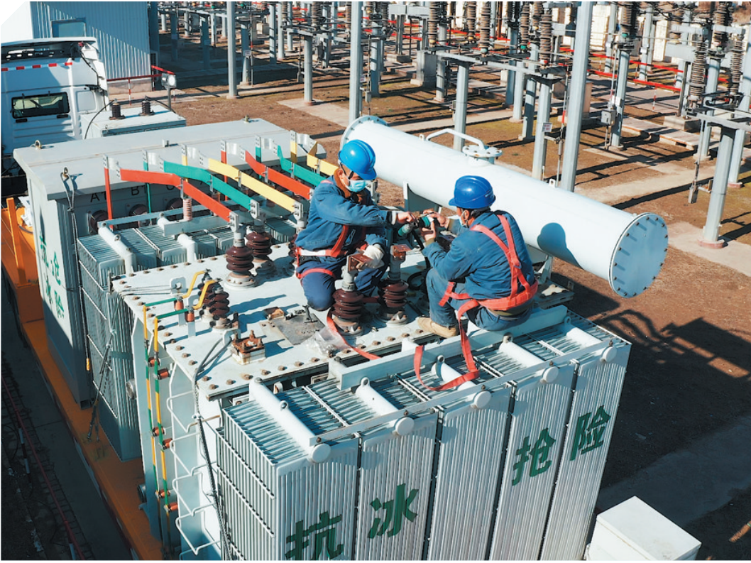
12月14日,国网河北省电力公司首台移动直流融冰车在沧州临海220千伏变电站就位,国网沧州供电公司在临海站内举行了实战融冰应急演练。据悉,该融冰车额定容量14.2兆瓦,最长融冰线路距离可达100公里。与传统的除冰方式相比工作效率提升了30%。通过应急演练,提升了装置应对雨雪冰冻灾害时的应急响应能力,确保在线路覆冰等应急情况下快速启动,保障电网安全运行。张超 王斌 摄
