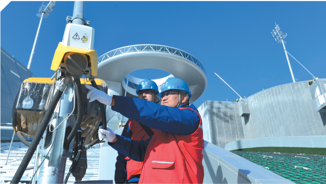
12月6日,唐山供电公司冬奥保障团队队员在通往国家跳台滑雪中心顶峰的台阶上,检查造雪机用电设备和自备发电机用电设备电源的安全,为冬奥各场馆安全用电提供保障。 负明权 摄
