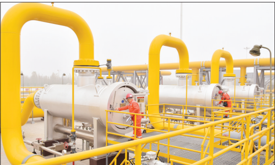
为应对寒潮和雨雪天气,中俄东线天然气管道工程唐山联络压气站组织技术人员对天然气管网线路、机器设备运行情况进行巡检维护工作,积极消除安全隐患,确保冬季管网设施安全运行和天然气平稳供应。图为技术人员对输气管网进行安全巡检。 杨雨熏 齐磊 苏立颖 摄
