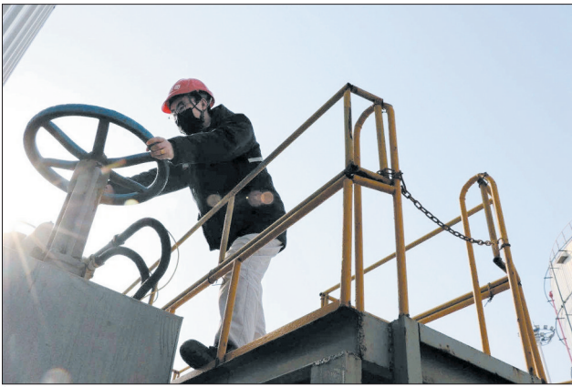
河北渤投集团所属海丰公司输油管理部油槽工正在切换转输工艺流程。据悉,今年一季度,河北渤投集团共接卸油轮45艘次,油品输油量达到166万吨,较去年同期增长23%;其中三月份完成输油63万吨,创造了历年单月输油量的新高。 崔上 赵晨静 摄
