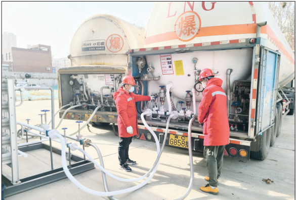
3月22日,因上游供气单位进行维检修作业,暂停向下游供气,秦皇岛泰兴天然气有限公司迅速启动“保民用、保公用、保重点”的专项保供方案,全力保障居民、公服、工业用户平稳用气。图为工作人员进行LNG气化操作。
