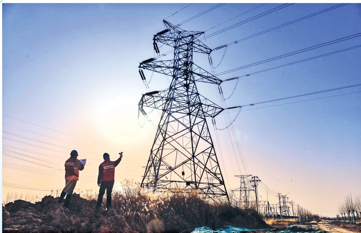
新春将至,国网衡水市桃城区供电公司春节保电工作作为当前工作的重中之重,坚持技术与管理措施并重,全身心投入、全方面准备、全过程控制、全方位服务,提前打响春节保电“保卫战”。图为工作人员检查高压输电设备。 利天林 闫学诗 摄
