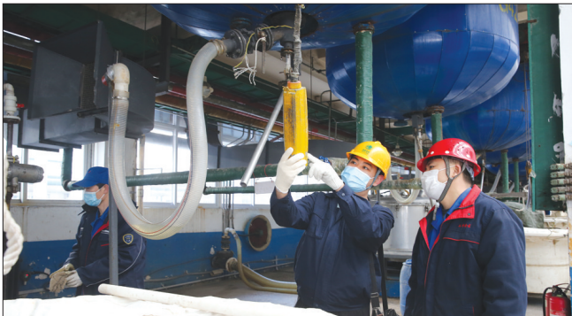
截至2月2日,国网石家庄供电公司累计供电40.98亿千瓦时,同比增长0.51%,疫情以来首次实现由负转正。图为工作人员帮助企业检查配电设施。 康伟 摄
