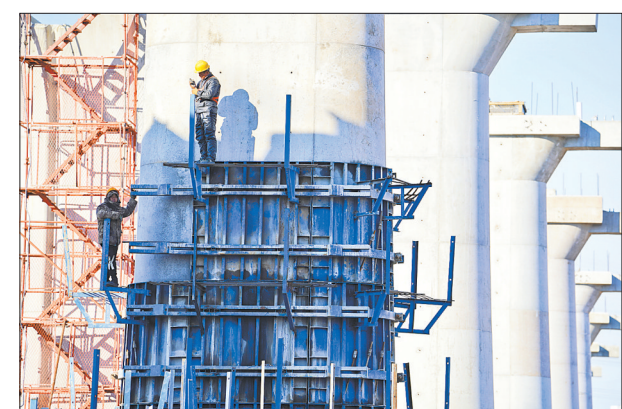
11月30日,工人在京唐城际铁路廊坊市三河段建设工地施工。目前,京唐(北京至唐山)城际铁路稳步推进,工程进展顺利。京唐城际铁路起点位于北京市通州区的城市副中心站,终点位于唐山市唐山站,线路长约148.7公里,最高设计时速为350公里。
