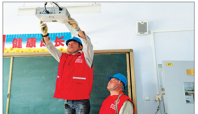
“开学季”来临,8月28日,冀北唐山供电公司“钢铁之魂”共产党员服务队来到丰润区沙流河小学,对校园用电安全“把脉问诊”,确保学校用电安全可靠。刘静 摄
