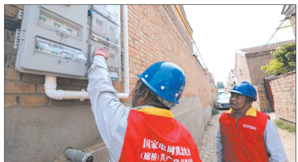
近日，文安县供电公司对各庄镇张管庄村制订增容改造方案，投资110万元，架设低压线路1.52千米，接户线5.2千米，改造电表箱80个，为村民发展生产、脱贫致富提供了坚实的电力保障。 张伟 摄
