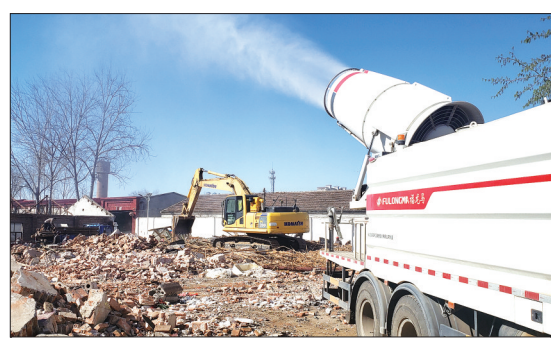
今年以来,安平迅速掀起“大拆迁、大整治、大建设、大提升”热潮,多措并举治理违建,形成“全党动员、全民参战”的生动局面,全力打好拆违攻坚战。图为拆违现场。
