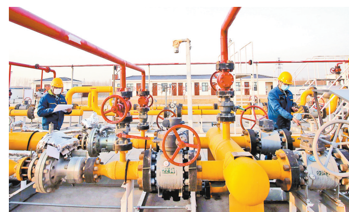
自新冠肺炎疫情发生以来,位于邯郸市永年区的河北华燃长通燃气有限公司在做好疫情防控的同时,通过协调上游补充气源、巡检燃气设备、开通服务热线等形式,全力保障居民生活、企业复工复产的天然气安全平稳供应。图为河北华燃长通燃气有限公司工作人员在双陵天然气分输门站巡检。 任阳光 胡高雷 常领山 摄
