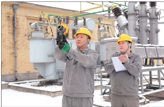
针对近期强降雪等天气对电网带来的不利影响,国网大厂供电公司立即启动应急预案,组织人员加强对重要线路、重载设备的巡视和监控。图为该供电公司员工给35千伏工业变电站电气设备测温。
