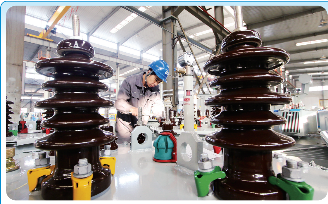
近年来,永年区工业园区坚持新发展理念,以供侧结构性改革为主线,加快新旧动能转换,围绕新能源、新材料、高端装备制造等领域,打造高新技术产业集群,助推当地经济高质量发展。图为员工正在位于永年工业园区的高晶电器设备企业工作。 胡高雷 赵明 摄
