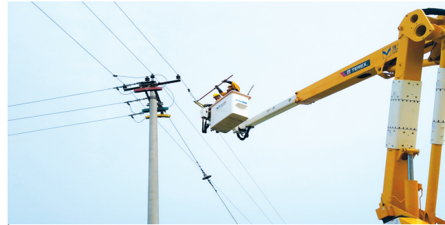
9月1日,涿州供电公司采用带电作业方式,开展秋检消缺工作,以确保学校正常用电需求。图为该公司员工在10千伏城西农业519线路10号杆更换设备线夹。李阳阳 摄
