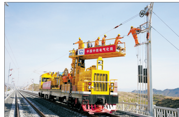
5月7日,中铁电气化局的工人在京张高铁下花园段施工。目前,京张高铁供电、通信、信号、电力“四电”工程施工进展顺利。新华社记者 杨世尧 摄
