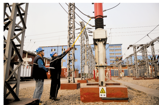
年初以来,开滦范各庄矿业公司以确保矿井机电设备安全运转为目标,进一步健全完善设备检修制度和设备包机检修制度,明确检修人员职责,加强设备检修质量管理,确保设备安全高效运转。图为公司机电科变电站员工正在对供电设备进行巡视。
