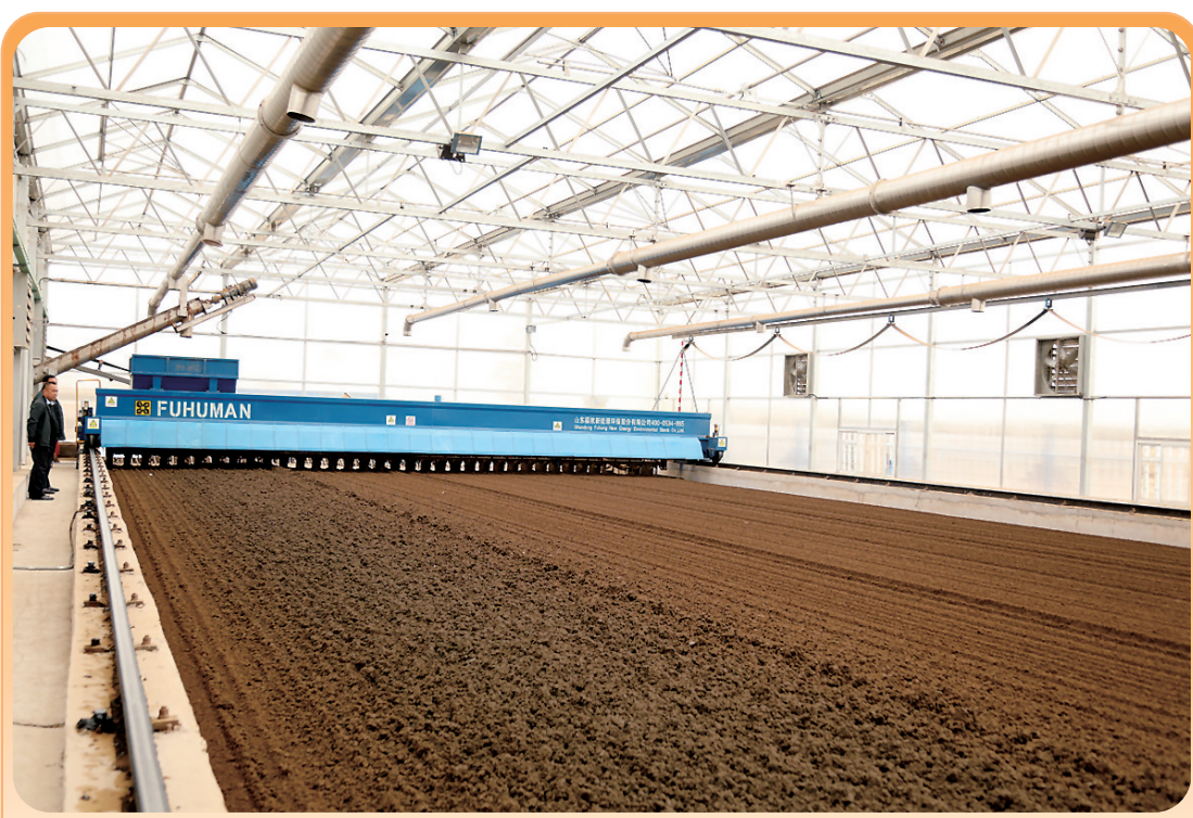
枣强县污泥处置中心总投资800万元,占地面积3300平方米,采用太阳能干化工艺,日处理污泥15吨,使污泥含水率率达到60%以下,符合国家标准,达到了污泥处置稳定化、无害化和资源化,实现了污泥处置的生态环保。截至目前,共处置污泥3200吨。图为自动摊铺机正在太阳能温室干化处置车间进行作业。 杨双池 摄
