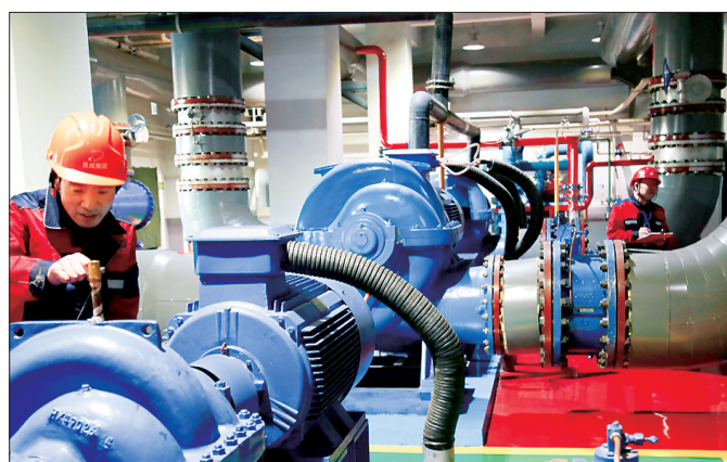
10月以来,坝上气温屡创新低,10月8日洁源热力公司提前点火,从11日下午开始陆续输水供热,保障广大市民温暖越冬。 梁志刚 摄
