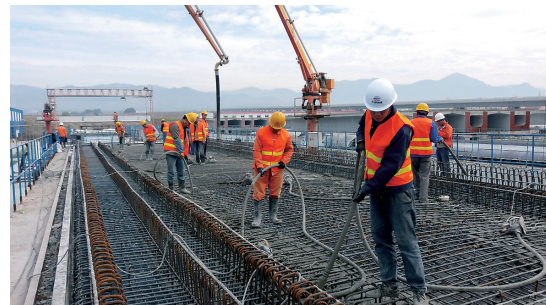
经过300多名建设者近两年日夜艰苦奋战,由中铁二十局二公司宣化梁场负责施工的崇礼铁路全线519片箱梁预制日前完美收官。图为建设者浇筑最后一块32米单线箱梁场景。 曲志忠 摄
