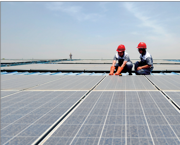
近年来,全国重要玻璃生产集散地——沙河市大力推广工业清洁能源替代,利用工业区厂房屋顶架设光伏发电设备,建设屋顶分布式光伏电站。产生的清洁电能由企业自用或上网销售,降低企业生产成本,让屋顶“生金”。目前,全市已建成企业屋顶分布式光伏电站60余座,总装机容量30兆瓦,年均发电量约3900万千瓦时,每年可节约标准煤燃烧1.2万吨。 图为工作人员在德盛工业园屋顶分布式光伏电站检修光伏板。 新华社记者 朱旭东 摄
