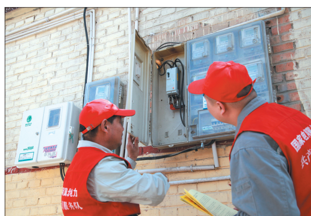
霸州公司部署辖区15支党员服务队开展农村安全用电隐患排查,组织服务队进村入户,认真检查农户家庭用电线路、插座、开关,检测各类电器的绝缘情况和安全性能,及时帮助村民更换老化、破损电线和电器配件,消除安全隐患。同时,排查配电箱、铁塔电杆和对电力线路走廊逐条进行检查等方式,积极开展线下违章建筑、取土、弱电线路搭挂等行为清理整治,并落实相应安全措施。(赵亚彬 摄)
