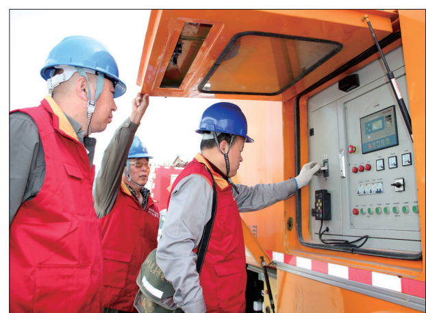
近日,国网东光县供电公司派员对驻点企业的应急电源车进行“体检”。国网东光县供电公司密切关注天气信息,积极制定应对恶劣天气保供电方案,成立安全保供电小组,细化各部门职责分工,随时做好应急抢修准备,保障供电可靠安全。 邢志杰 摄
