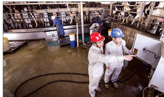
近日,国网三河市供电公司员工来到华夏畜牧(三河)公司,检查客户用电设备,排除用电隐患。图为公司员工在检查用电设备。邹明 摄
