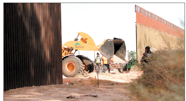
2月22日,在美国加利福尼亚州南部卡莱克西科市附近,工人们在替换边境隔离墙。美国海关和边境保护局21日宣布,美国联邦政府当天启动了美国与墨西哥边境隔离墙的修建工程,将首先开始对加利福尼亚州南部卡莱克西科市市中心一段隔离墙的替换工程。新华社/路透
